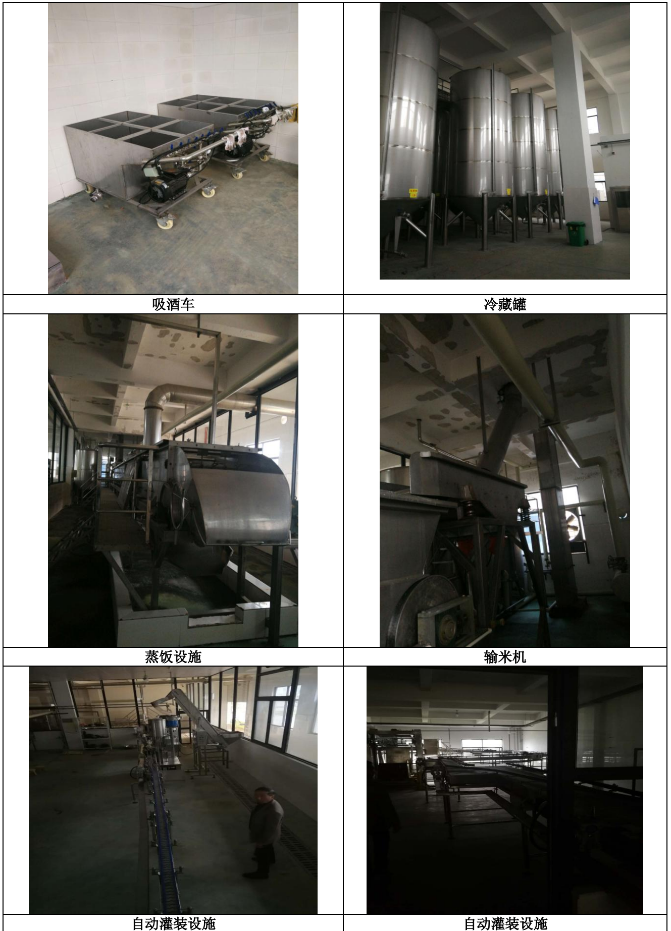
图3-6 项目主要设备现场照片
